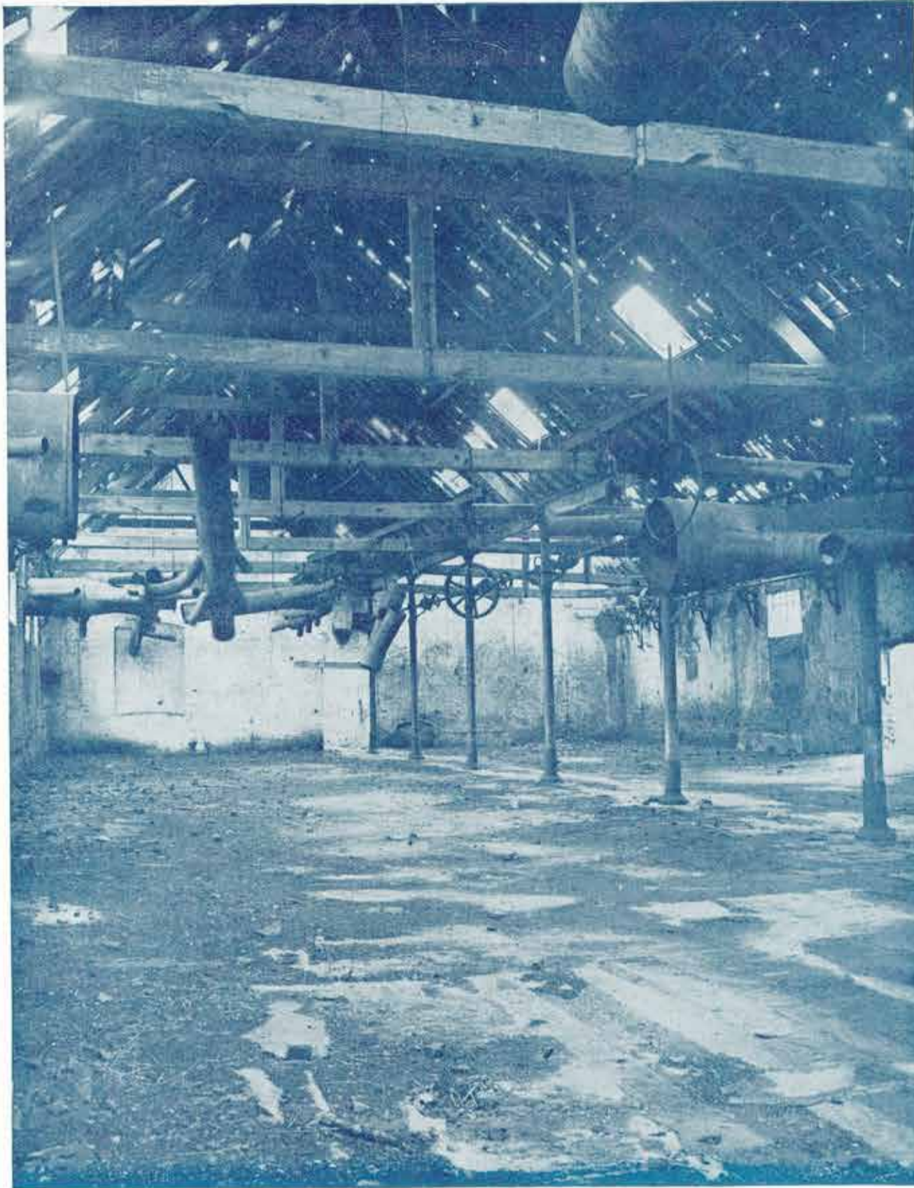
La toiture est effondrée et tout a été saccagé. Tel est le triste bilan de quatre années d'occupation allemande.
